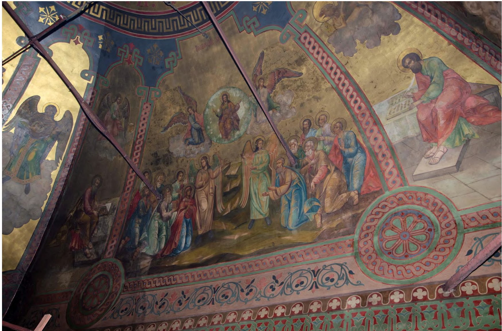
ОКН федерального значения "Церковь Всех Святых на Кулишках 1380 г. Перестроена в XVI-XVII в.в" по адресу: г. Москва, Славянская пл., д.2. Масляная монументальная живопись, 1877 г. с поновлением, реставрация 1990-х гг. Свод четверика, южный склон. Общий вид. До реставрации
